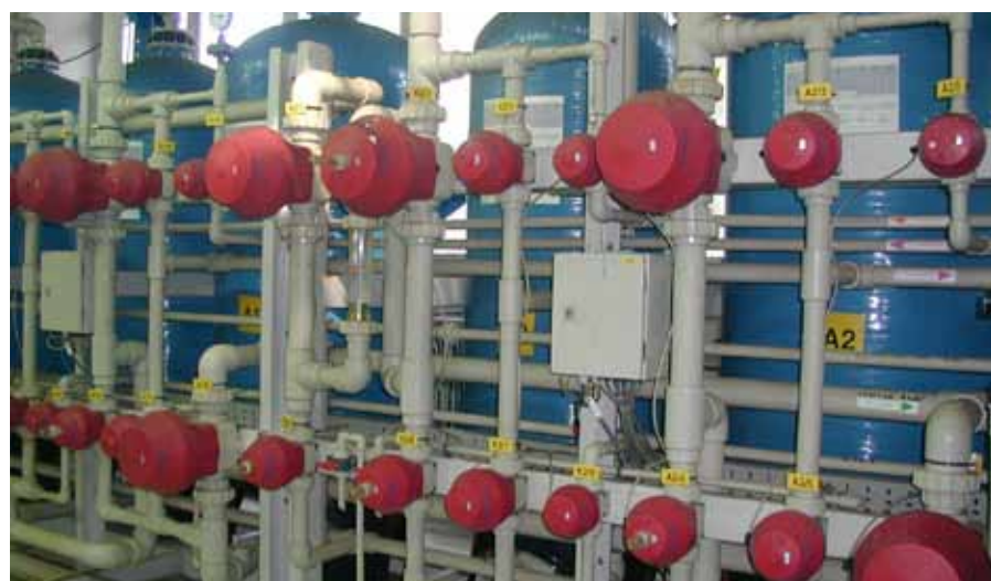
Krogotočna čistilna naprava z ionskimi izmenjevalci je v veliki meri prispevala k zmanjšanju količin in izboljšanju kakovosti odpadne tehnološke vode.
